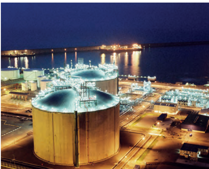
Fuente: https://www.sedigas.es/imagenes | Planta de licuefacción y regasificación BBG, EVE
